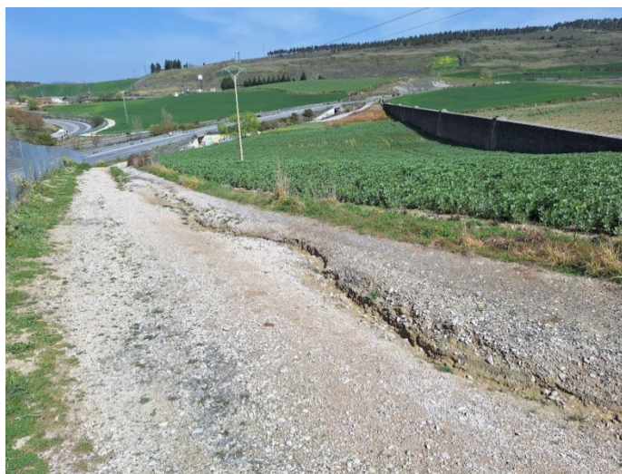
Rampa con incisiones por arroyada del Camino 2.-
